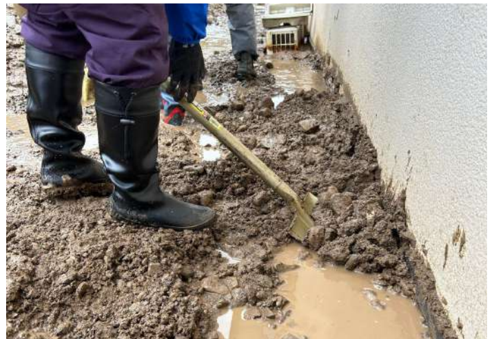
建物周りは人力が頼り、土砂が非常に重くなっている
